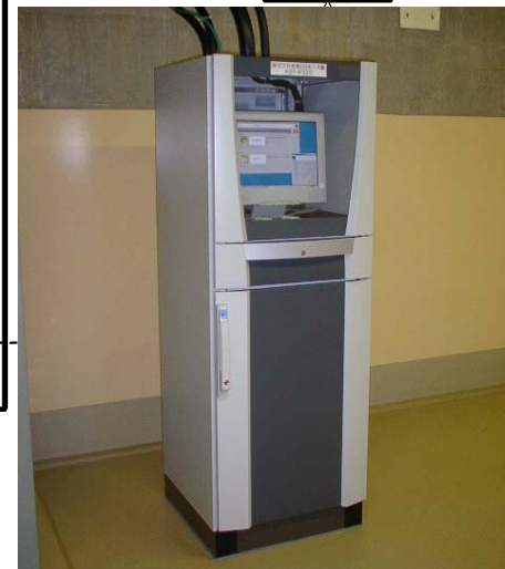
DMCA／監視装置(現場)
