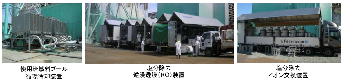
図7 水質浄化システム（外観）
